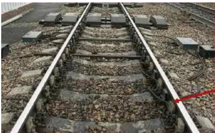
Рисунок 1. Фотография напольного оборудования ДДК
