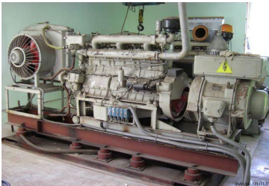
Рис. 1 - Автоматизированная дизель-генераторная установка
